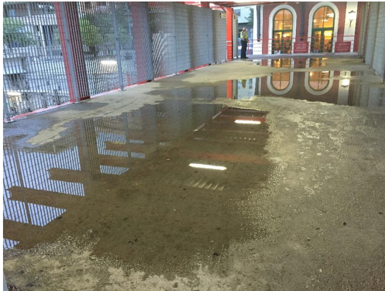
Figura 6: cada vegada que plou els accessos a les andanes de l'estació de Vilafranca queden amb bassals. Font: PTP.
