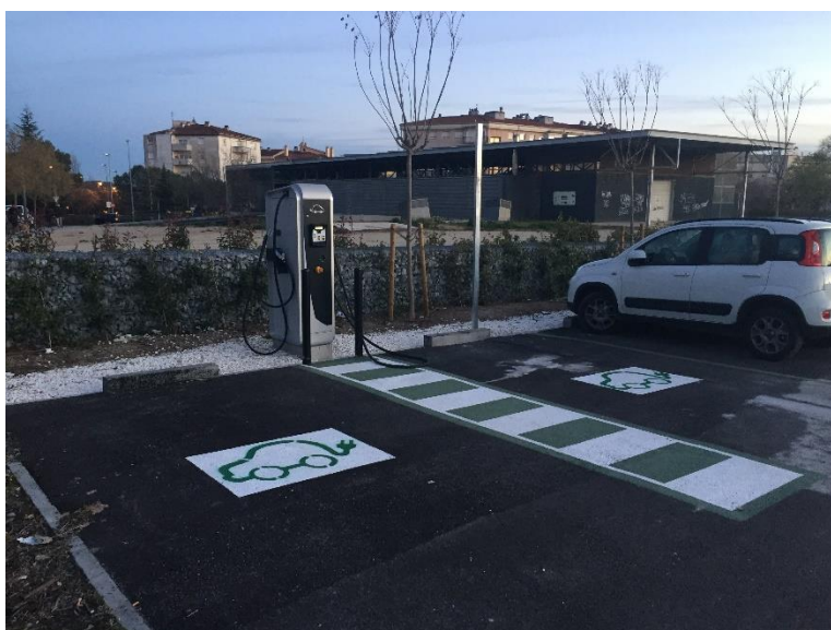
Figura 8: punt de recàrrega de vehicles elèctrics a Vilafranca. Font: PTP.
